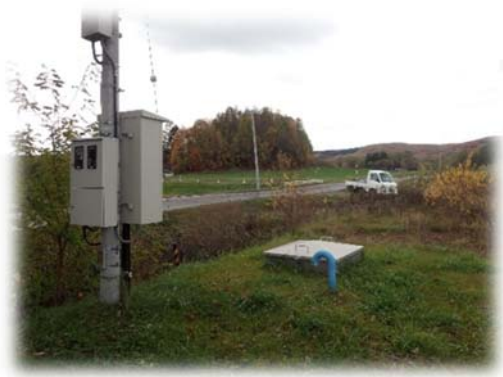
住吉ポンプ場
