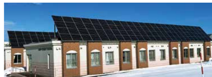
東藻琴生活支援ハウス悠久の里ソーラーシステム
