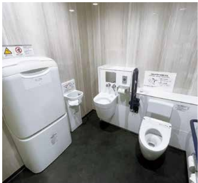
役場庁舎1階多機能トイレ（バリアフリートイレ）
