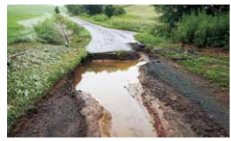
大雨の被害を受けた町道
