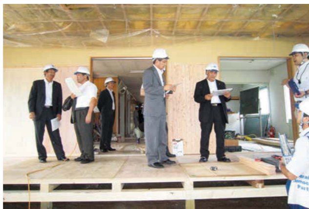
建設中の「東藻琴相撲場」を視察しました。現在は完成し、将来有望な子どもたちが汗を流しています。
