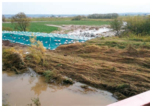
サラカオーマキン川堤防敷地内の被災状況 (H27.10.11撮影)
