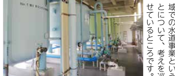
昭和浄水場のろ過装置
