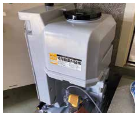
レジオネラ対策で設置した薬注ポンプ (7月16日撮影)
