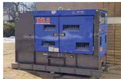
増設した発電機
