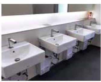
区域内の汚水は下水道により処理
