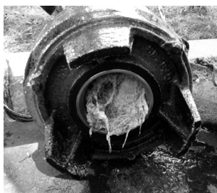
汚水を送るポンプに絡まった布
