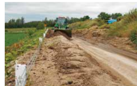
町道巴沢日進線の法面崩落
