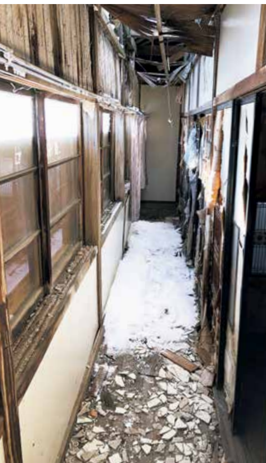
▲屋根が朽ち落ちてしまい、中に雪が堆積している。
