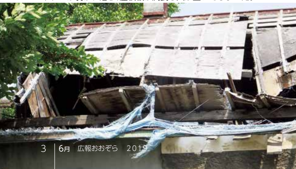
▼トタンが剥がれ落ち、屋根板が腐食し穴が空いてしまった。
