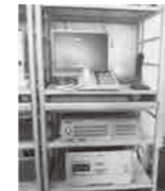
サイレン制御装置(親局)
