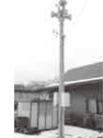
サイレン子局(新設) (湖畔地区)
